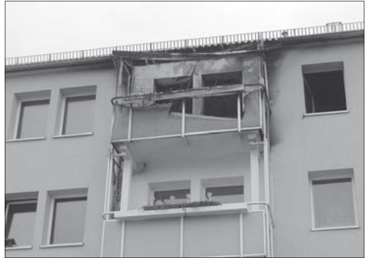
Verbrannter Balkon des Wohnhauses Essener Straße 58, Januar 2013
