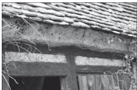
Beschädigte Lehm-mauer mit Dachkehle
